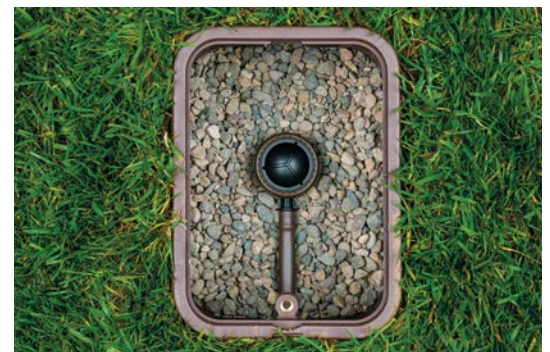
Válvula de descarga automática instalada
