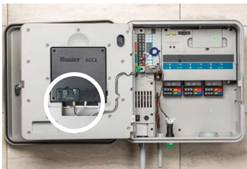
Programador ACC2 con módulo A2C-CELL-E instalado
