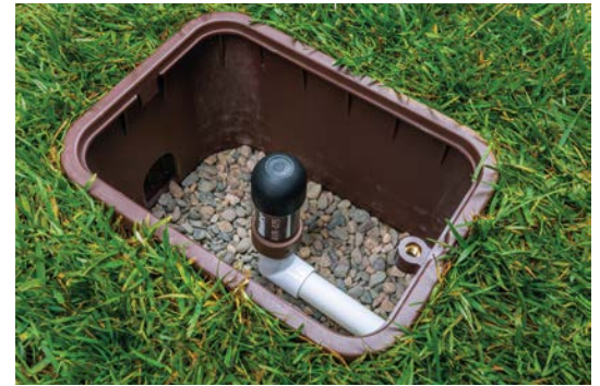
Válvula de ventosa de aire/vacío instalada
